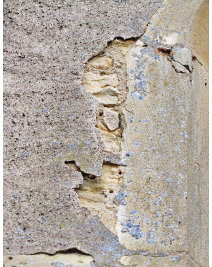
Dégradation des enduits extérieurs
