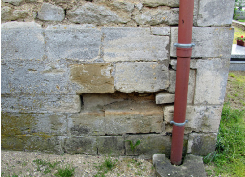
Mouvements de maçonnerie
