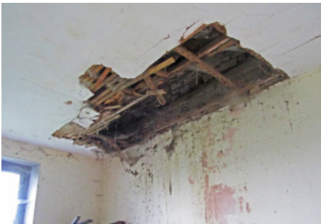
Effet d'une fuite de toiture sur un plafond
