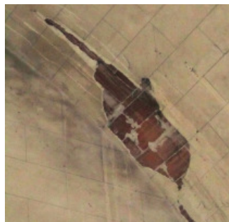
Effet d'une fuite de toiture sur une voûte
