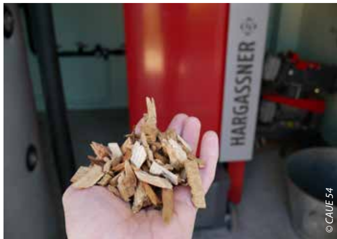
Les plaquettes forestières qui alimentent la chaufferie bois de la commune. A gauche le ballon tampon, à droite la vis sans fin qui alimente la chaudière.
