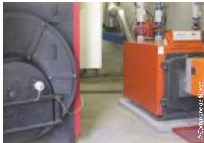
Local chaufferie bois de la commune de Moyen.
